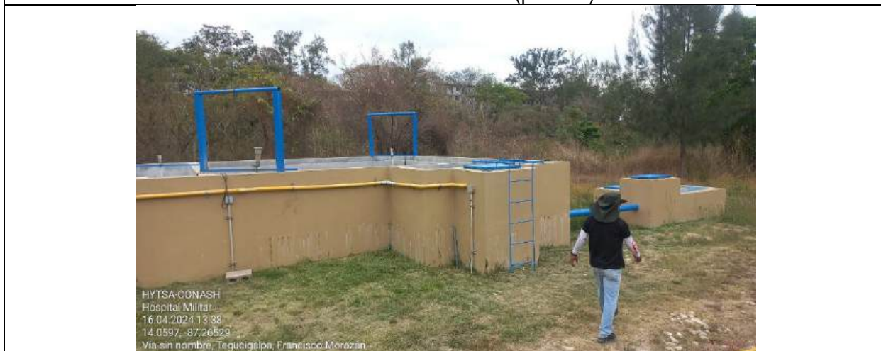
Estructura de tratamiento (planta 2)
