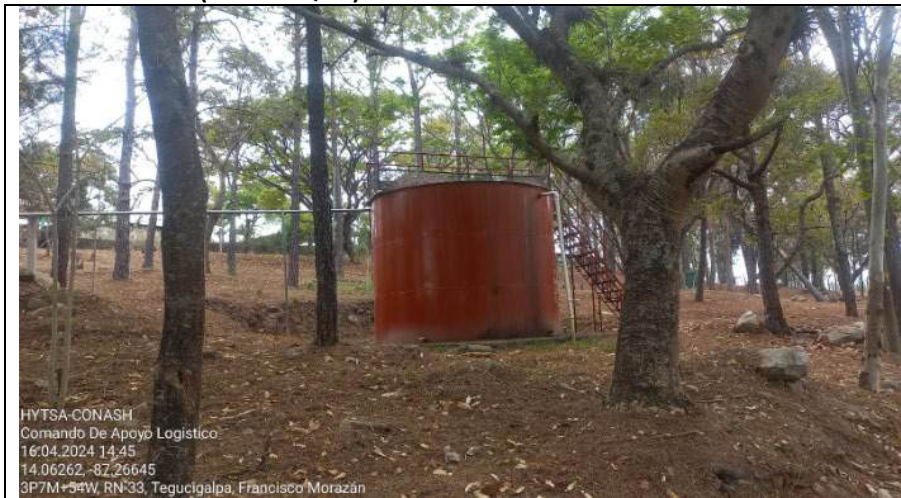
Planta de tratamiento 1 y cañería de llegada hacia la planta
