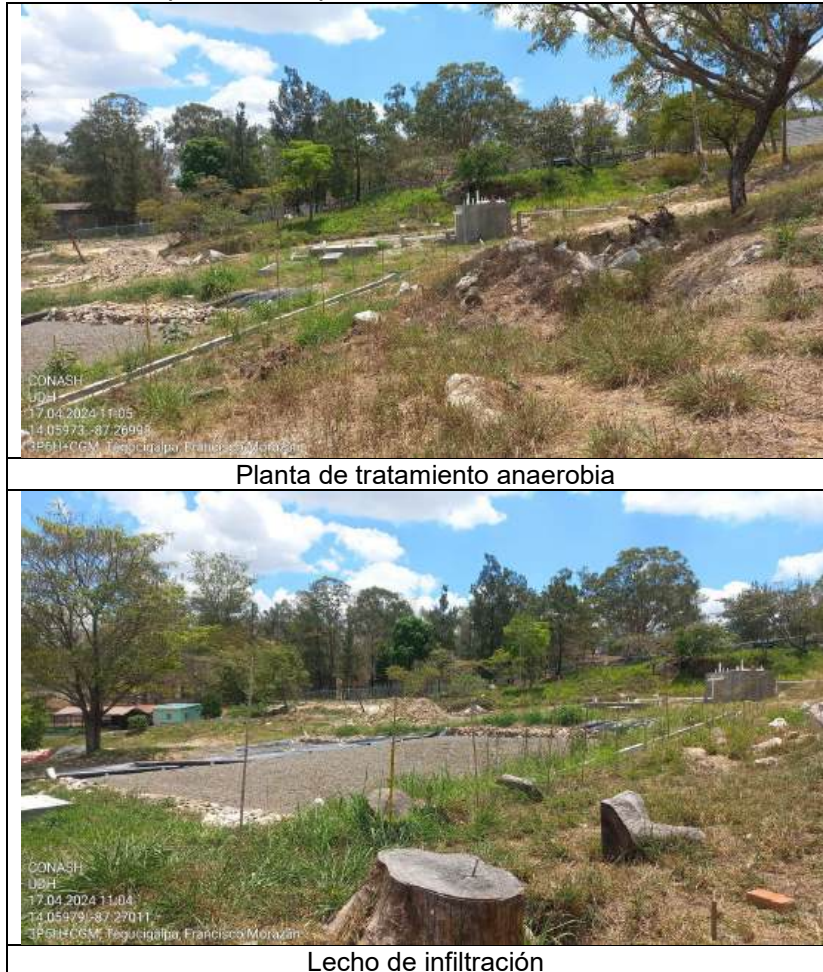
Figura 9. Instalaciones de saneamiento en la Universidad de Defensa
