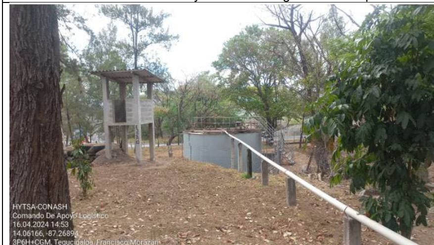
Planta de tratamiento 2 y cañería de transporte hacia la planta
