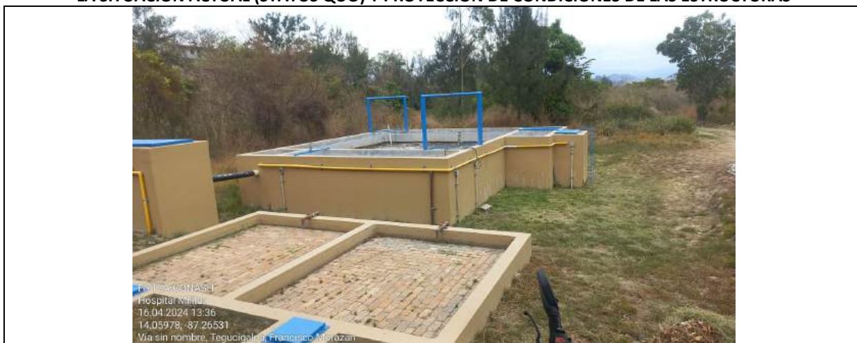
Estructura de tratamiento (planta 2)
