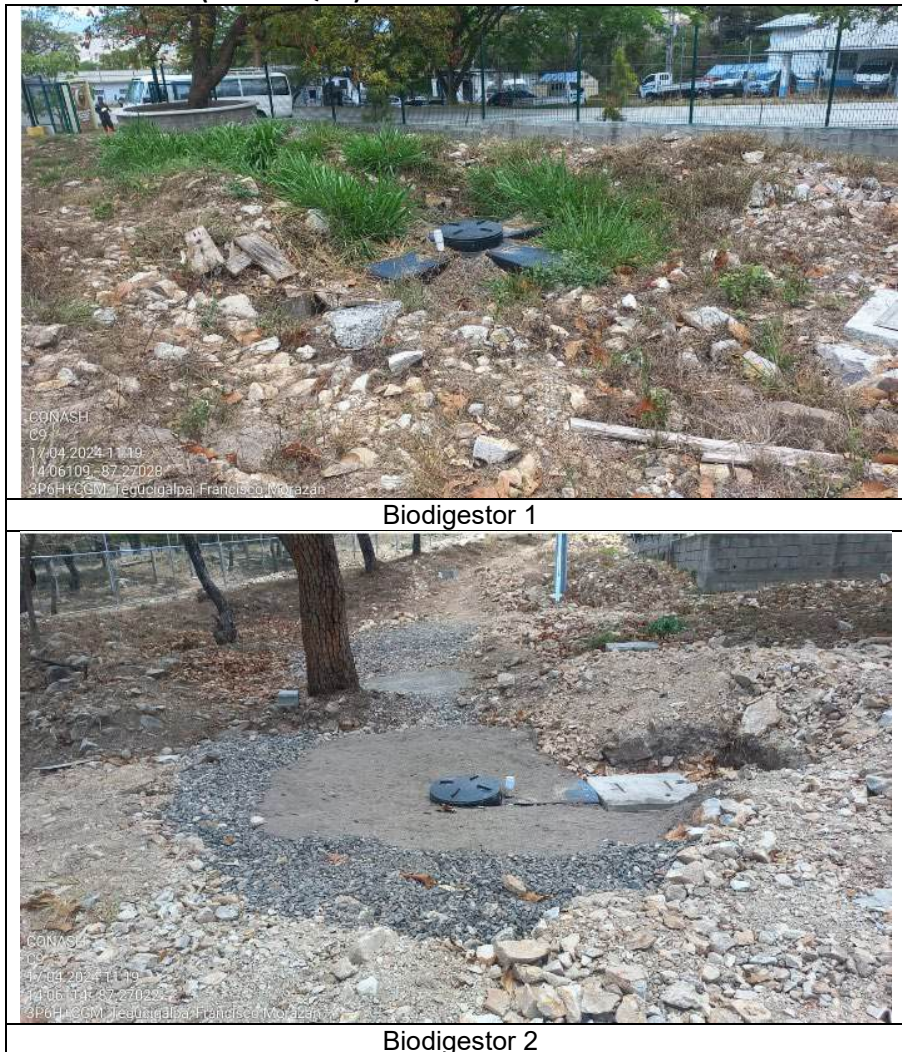
Figura 10. Instalaciones de saneamiento en el Comando de apoyo al manejo de ecosistemas y ambiente
