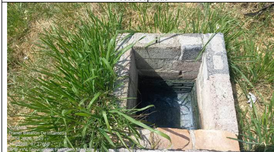
Caja de inspección
