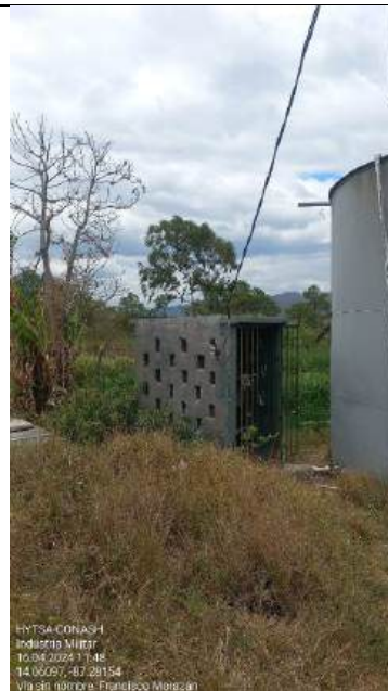
Panel de control de la planta
