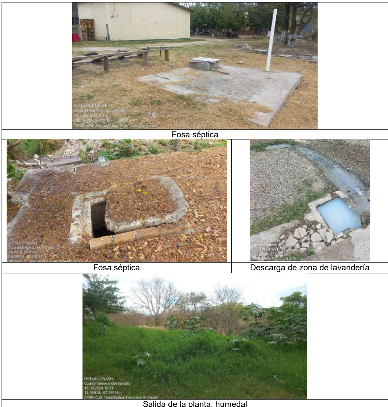
Figura 6. Instalaciones de saneamiento en el cuartel general
